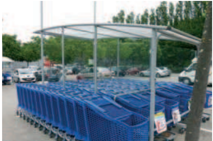
An diesem Unterstand für Einkaufswagen stellen die fast nicht erkennbaren Plexiglaswände eine Gefahr dar.
